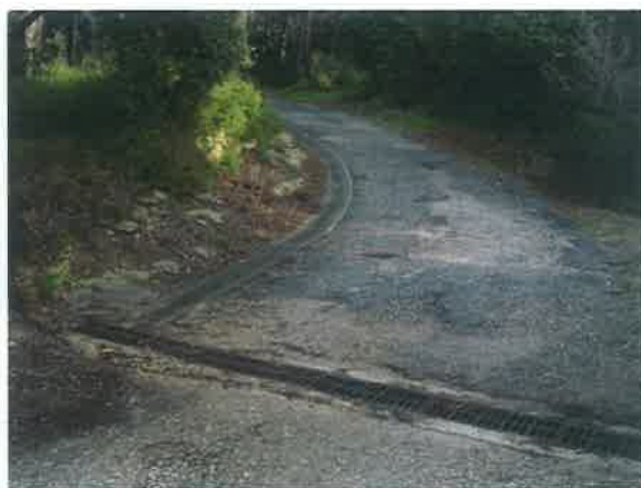
Interception des ruissellements par le caniveau à grille
