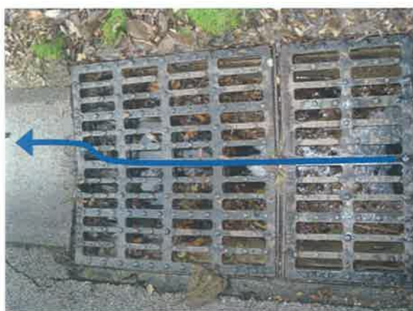
Refoulement du collecteur dans la cunette
