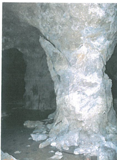
Photo n°1 - Rupture de pilier : Guide technique "cavités souterraines"
