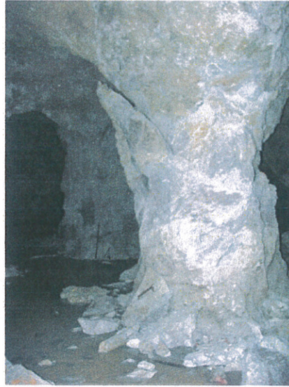
Photo n°1 - Rupture de pilier : Guide technique "cavités souterraines"
