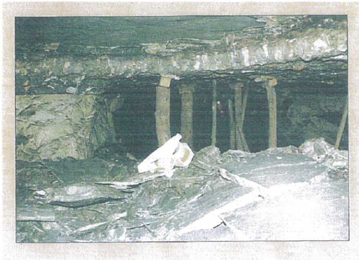
Photo n°2 - Rupture de toit : Guide technique "cavités souterraines"
