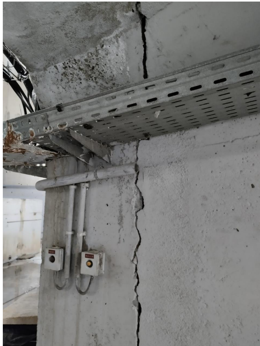
Photo 6 : Galerie n°2 – Décollement à l'entrée sous-sol ventilateurs
