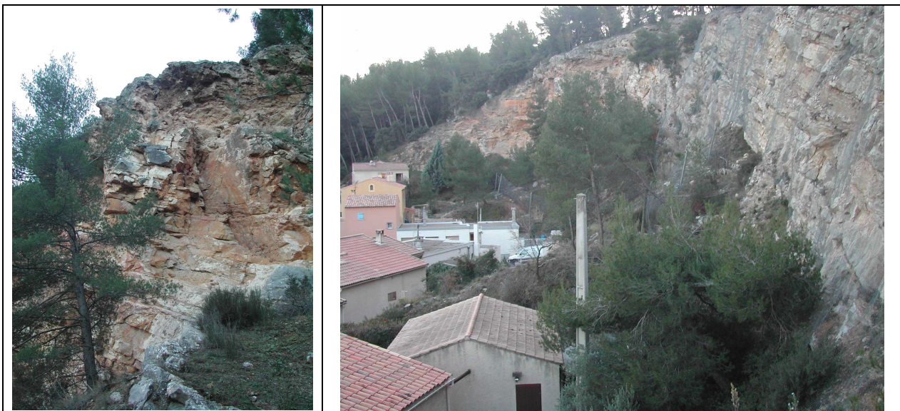
Photo. 2: Instabilités potentielles et parades géotechniques au droit de l'ancienne carrière.
