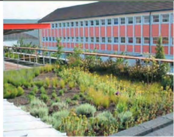
Toiture stockante végétalisée
